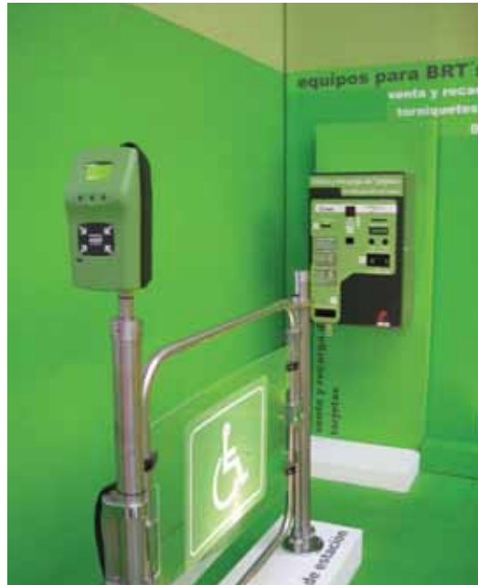
Sistema integral de control de acceso.
